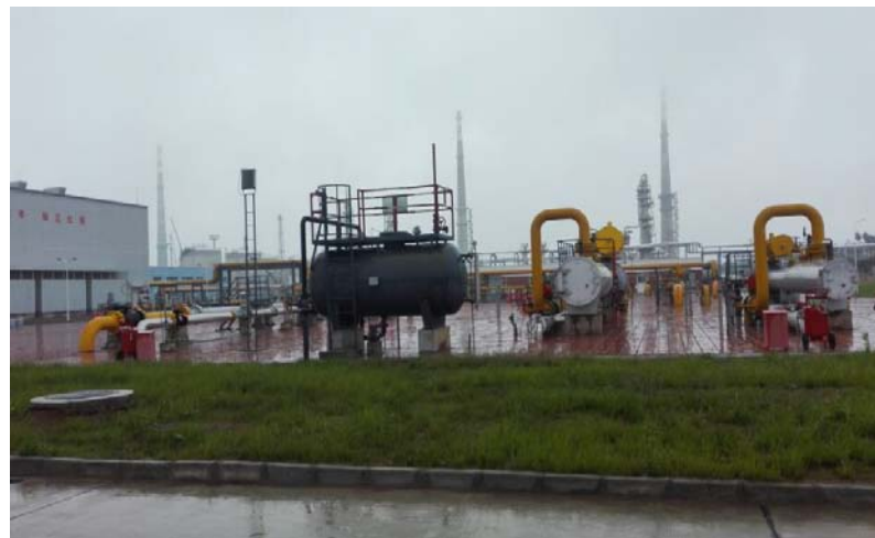
元坝首站工艺区
