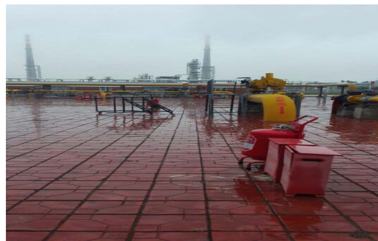
元坝首站消防设施
