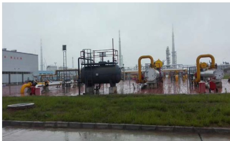
元坝首站污水罐
