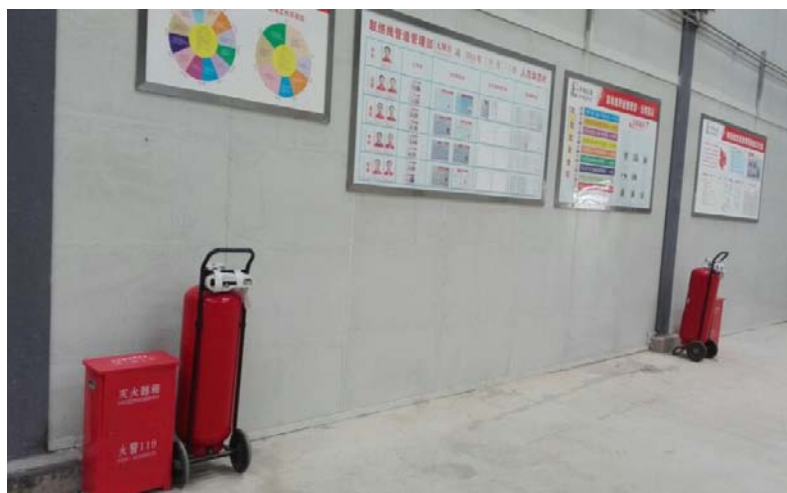
站场消防设施
