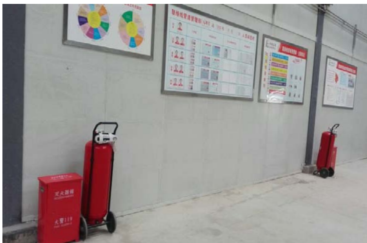
元坝首站消防设施
