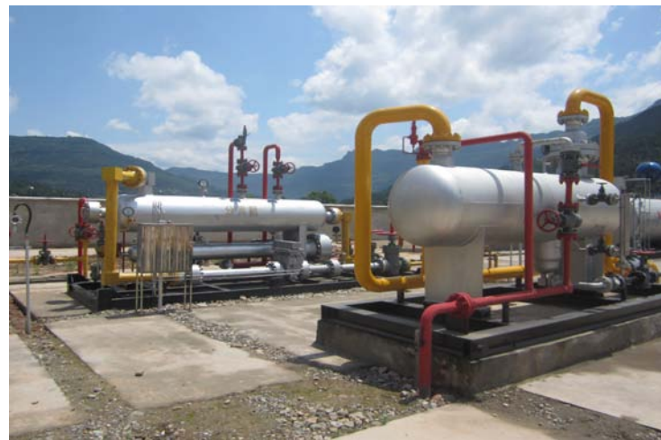
元陆 7 井集气站工艺区
