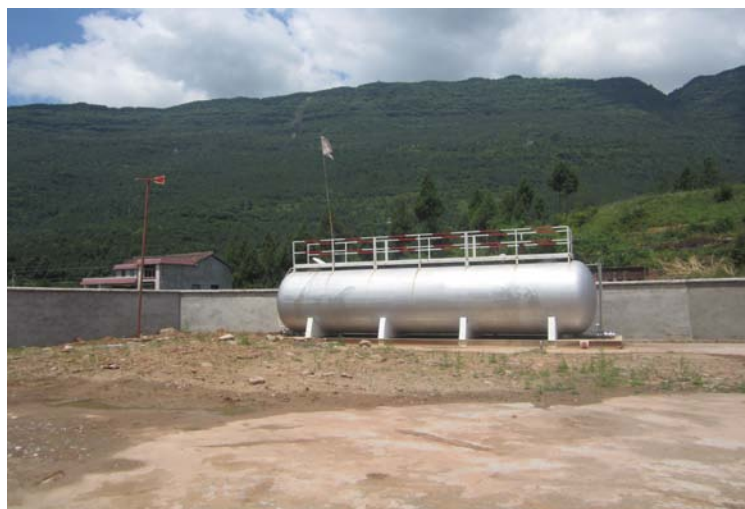
元陆 7 井集气站污水罐
