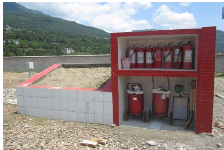
元陆 7 井集气站消防设施
