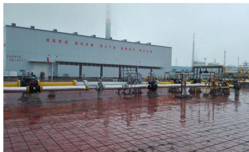
元坝首站工艺区
